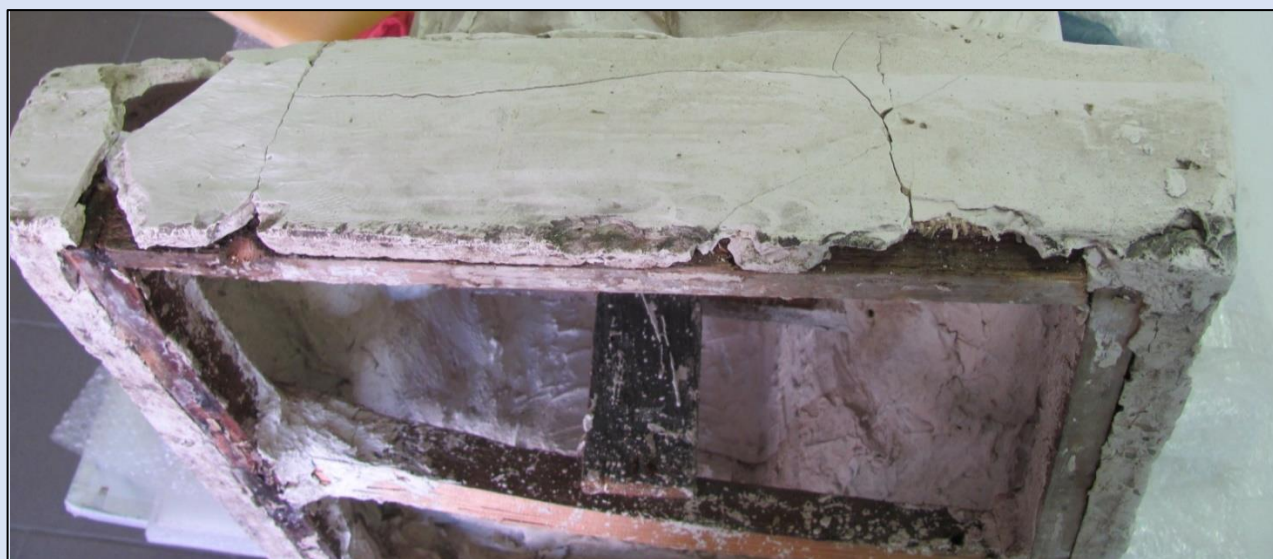
Pnutí nosné konstrukce – jedna z příčin vzniku prasklin
